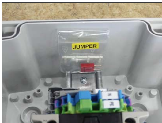
Перемычка и заглушка в электромонтажной коробке.
